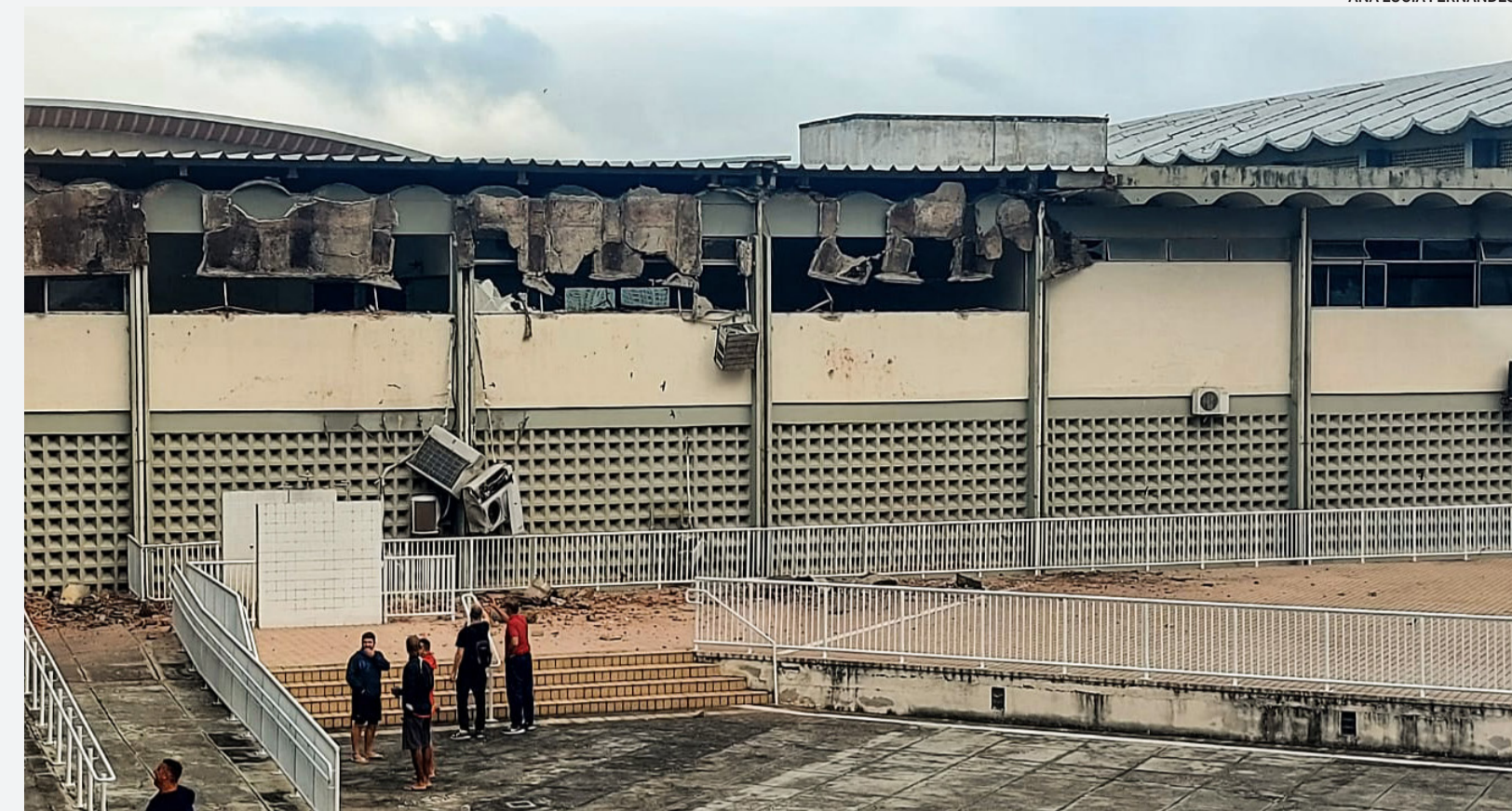
PERIGO A queda de parte do teto da Escola de Educação Física e Desportos mostrou a deterioração da infraestrutura da univesidade.
