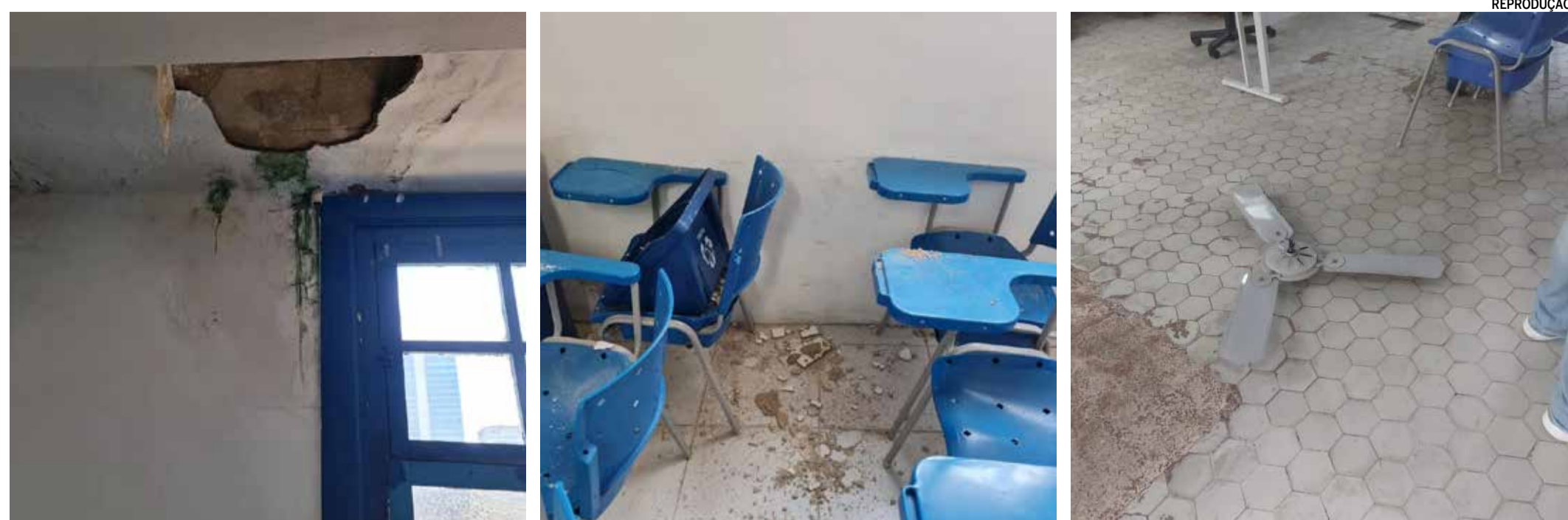
ACIDENTES EM SÉRIE: Reboco do teto da sala 406 caiu e um ventilador despençou do teto da sala 306. As duas salas estavam em aula e, por sorte, ninguém saiu ferido
