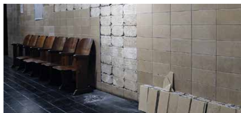
NO CORREDOR do quinto andar, cerâmicas se descolam da parede
