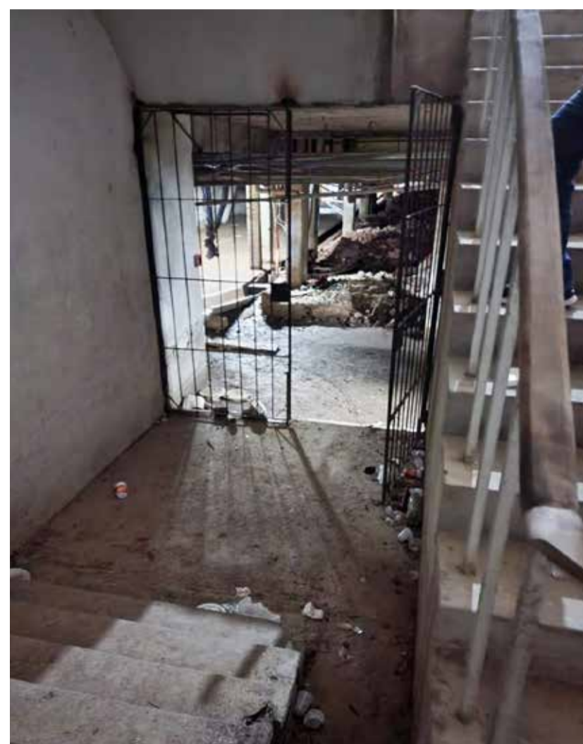
RESTOS de obras e alagamentos no subsolo, nos fundos do Bloco F
