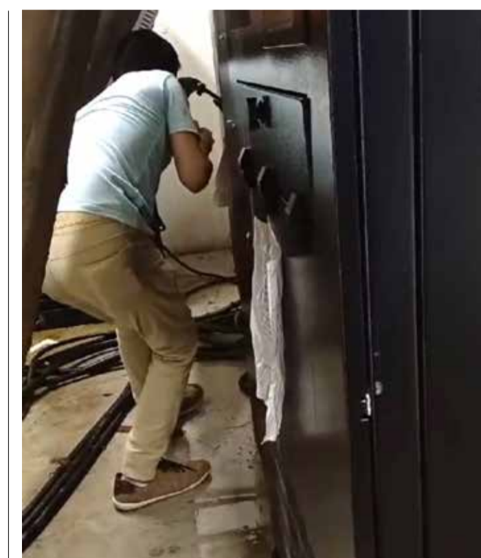
VAZAMENTO afetou o funcionamento do data center em meados de dezembro
