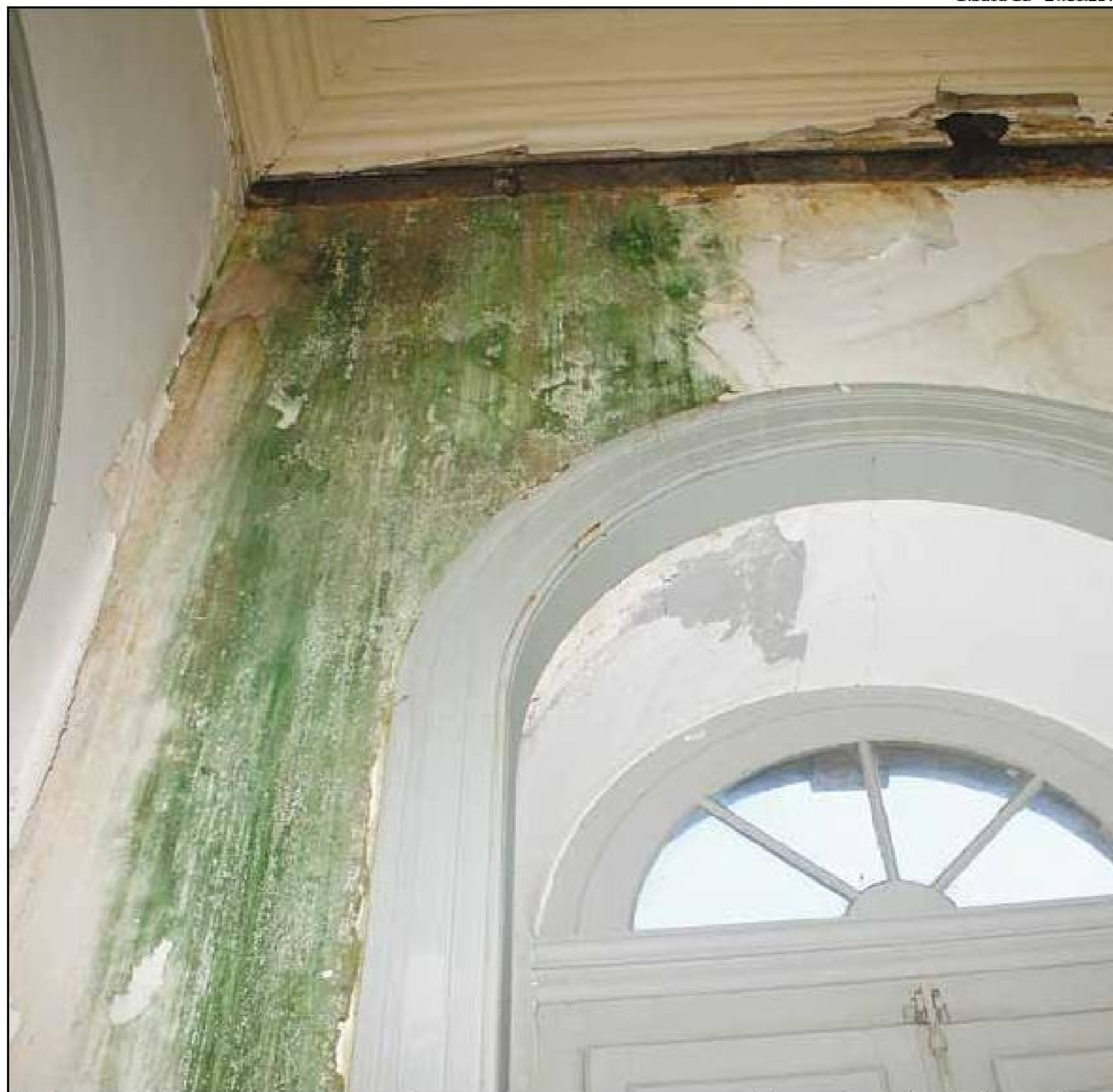
Estão sendo encaminhadas obras emergenciais, mas os problemas do telhado dependem de reforma sob a responsabilidade do ETU e da Prefeitura da UFRJ, informa a diretora em nota
