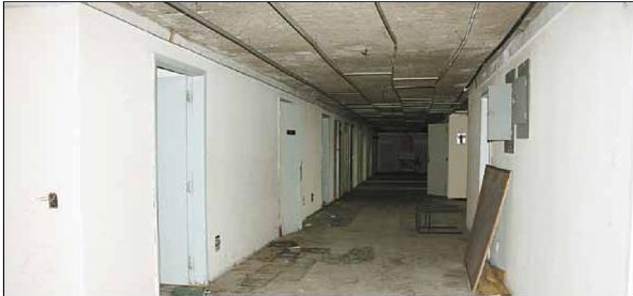
Uma das alas parcialmente vazias do hospital. Novo diretor quer ocupar esses locais com enfermarias, salas de cirurgia ou espaços administrativos
